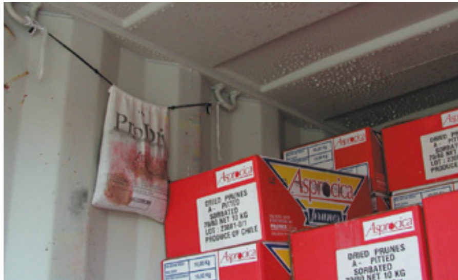
Kondensiertes Wasser am Dach, Trocknungsbeutel bereits sehr durchnässt
